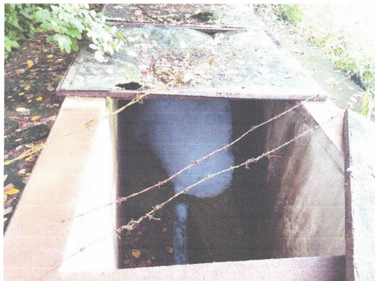
Fonte: Visita Técnica – Calha Parshal de saída.
