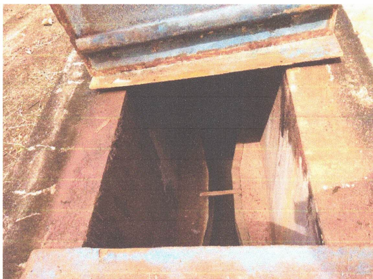
Fonte: Visita Técnica – Calha Parshall.
