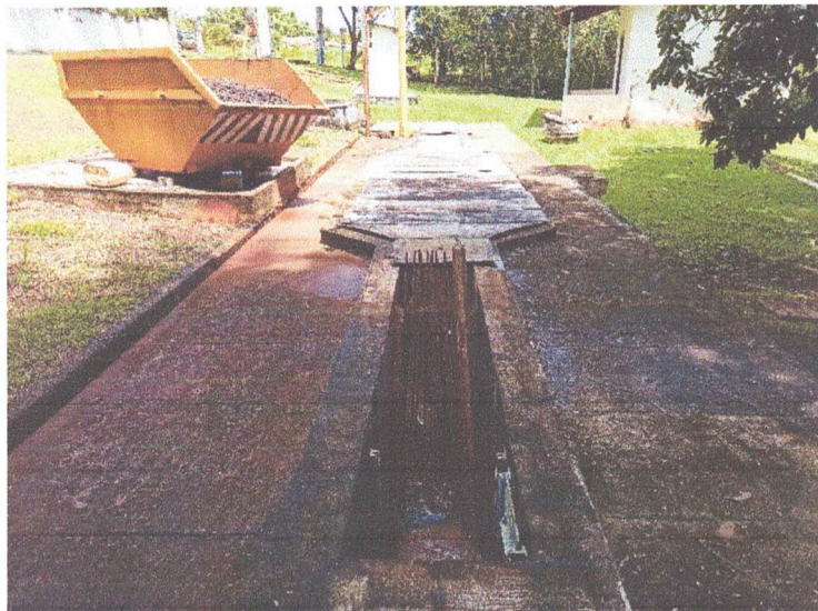
Fonte: Visita Técnica – Tratamento Preliminar.
