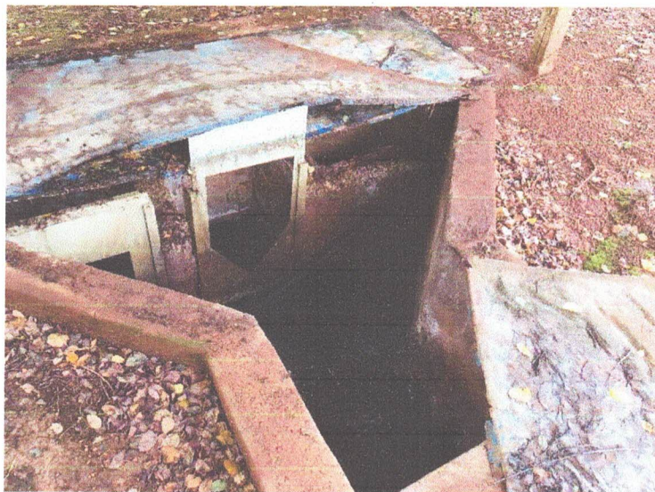
Fonte: Visita Técnica – Caixa de Distribuição.
